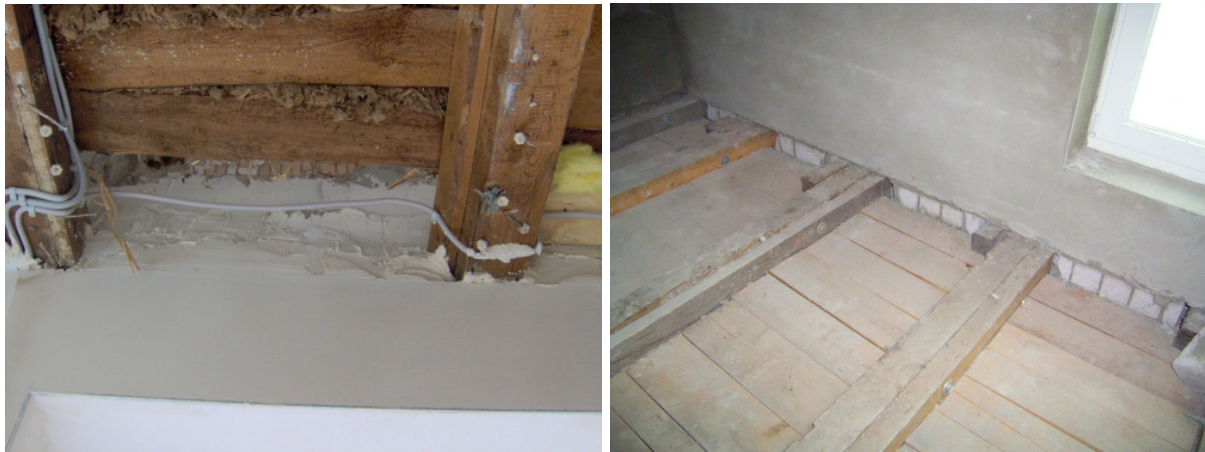
Abbildung 7: Zum Teil freigelegte Holzbalkendecken mit Wandaufleger der Holzbalken in zwei Sanierungsprojekten (Fotos: PHI)
