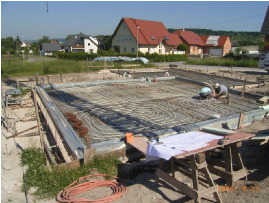
Abbildung 16: Verlegung der Rohrschlangen für die Fußbodenheizung in der Bodenplatte OBERHALB der Wärmedämmung (Foto: Trykowski).
