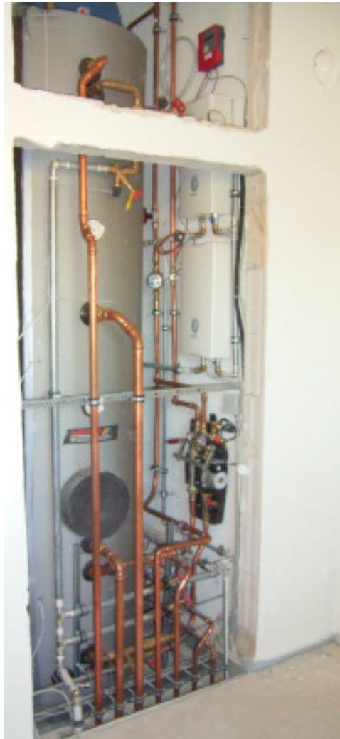
Abbildung 17: Warmwasserspeicher (750 Liter) im OG des Gebäudes vor der Dämmung der Rohrleitungen. Rechts neben dem Speicher befinden sich die beiden Durchlauferhitzer zur Nacherwärmung des Brauch-Warmwassers, darunter die Solarstation. Über den beiden Durchlauferhitzern befindet sich der Wärmehesähler (rot) für die Messung der Solarwärme.
