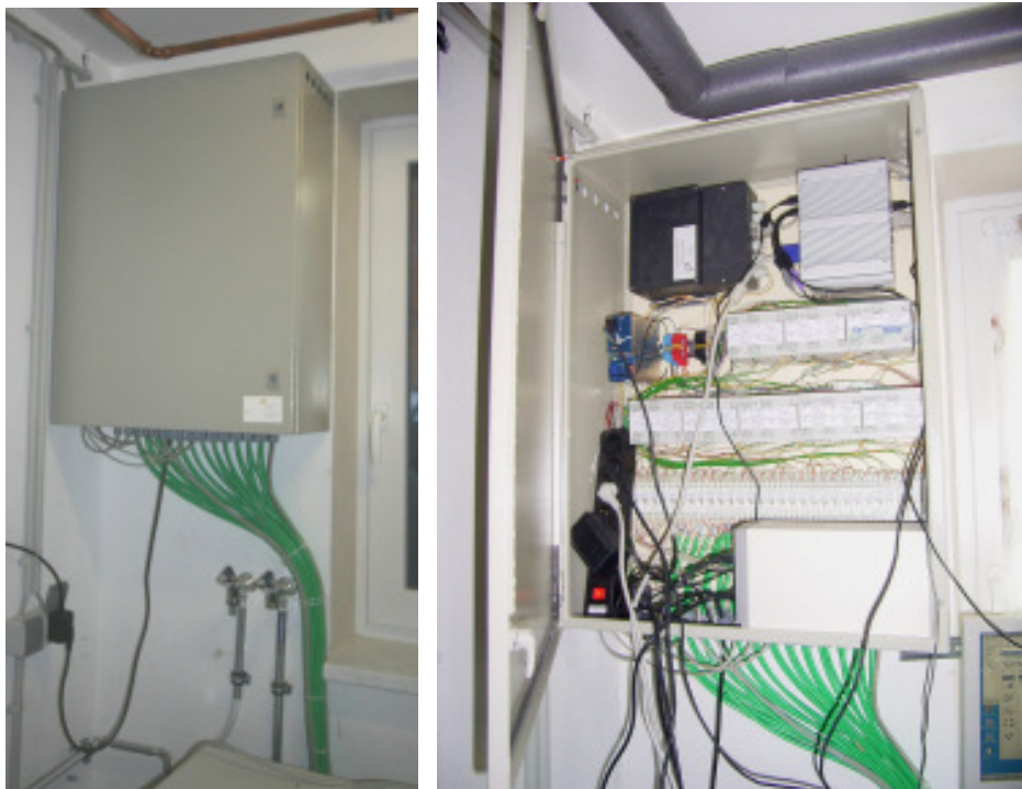
Abbildung 23: Schaltschrank mit der Messdatenerfassungsanlage im Haustechnikraum (EG).
