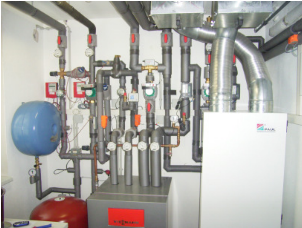
Abbildung 11: Haustechnik im EG. Rechts befindet sich das Lüftungsgerät, in der Mitte unten die Wärmepumpe.
