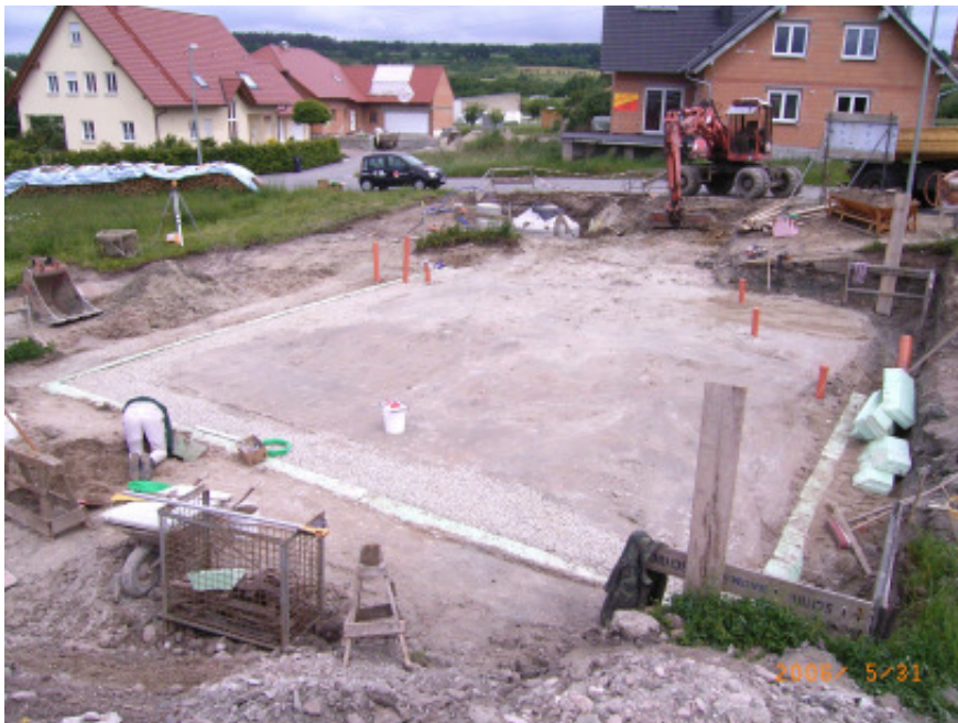
Abbildung 12: Planum vor dem Herstellen der Sauberkeitsschicht. Umlaufend ist die Oberkante der Dämmschürze zu erkennen, innen angrenzend eine Schotterfüllung bzw. „Schotterkeule“ (Foto: Trykowski).
