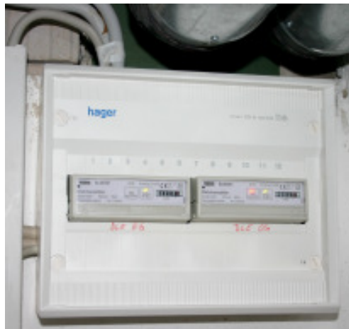
Abbildung 32: Stromzähler zum Messen der Verbräuche der beiden Durchlauferhitzer.
