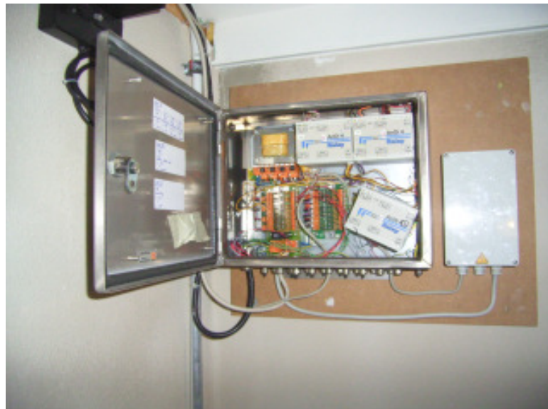
Abbildung 34: Geöffneter Elektroschaltkasten der Wettermessung während der Montage.
